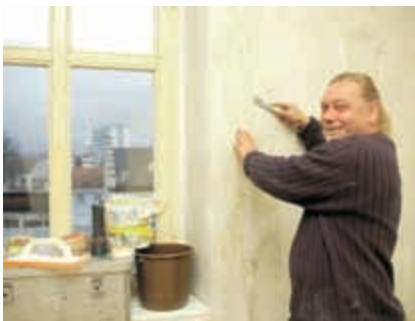
Die SAK-Arbeit gGmbH – von den Mitarbeitern "Bauhütte" getauft – übernahm in eigener Regie die Gewerke Abbruch, Gipser, Trockenbau und einen Teil der Malerarbeiten.
