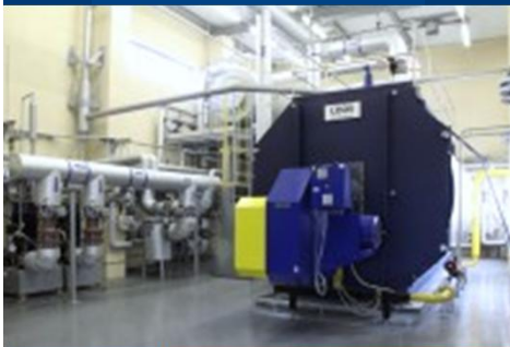
Die Spitzenwärmequelle mit dem Wasserrohrkessel, der mit dem Gas mit der Leistung von 15,6 MW befeuert wird.
