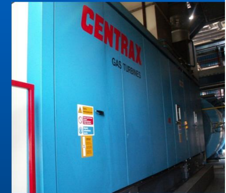
Die Gasturbine (2000) Centrax KB7 mit dem Wärmerückgewinnungskessel mit der Leistung von 11,6 MW
