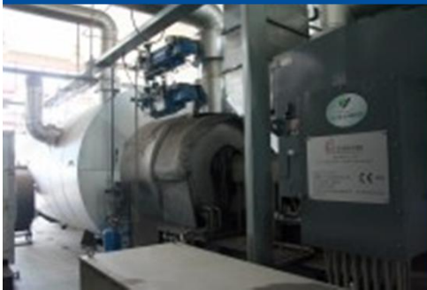
ORC- Block (2007) mit dem Umlauf für das Wärmeträgeöl, das mit der Biomasse mit der Wärmeleistung von 9,72 MW befeuert wird.
